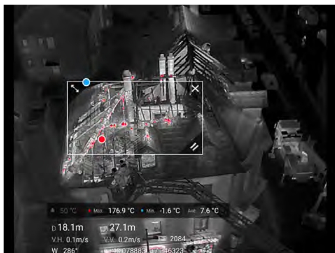
Recherche des points chauds à l'aide de la caméra thermique du drone
